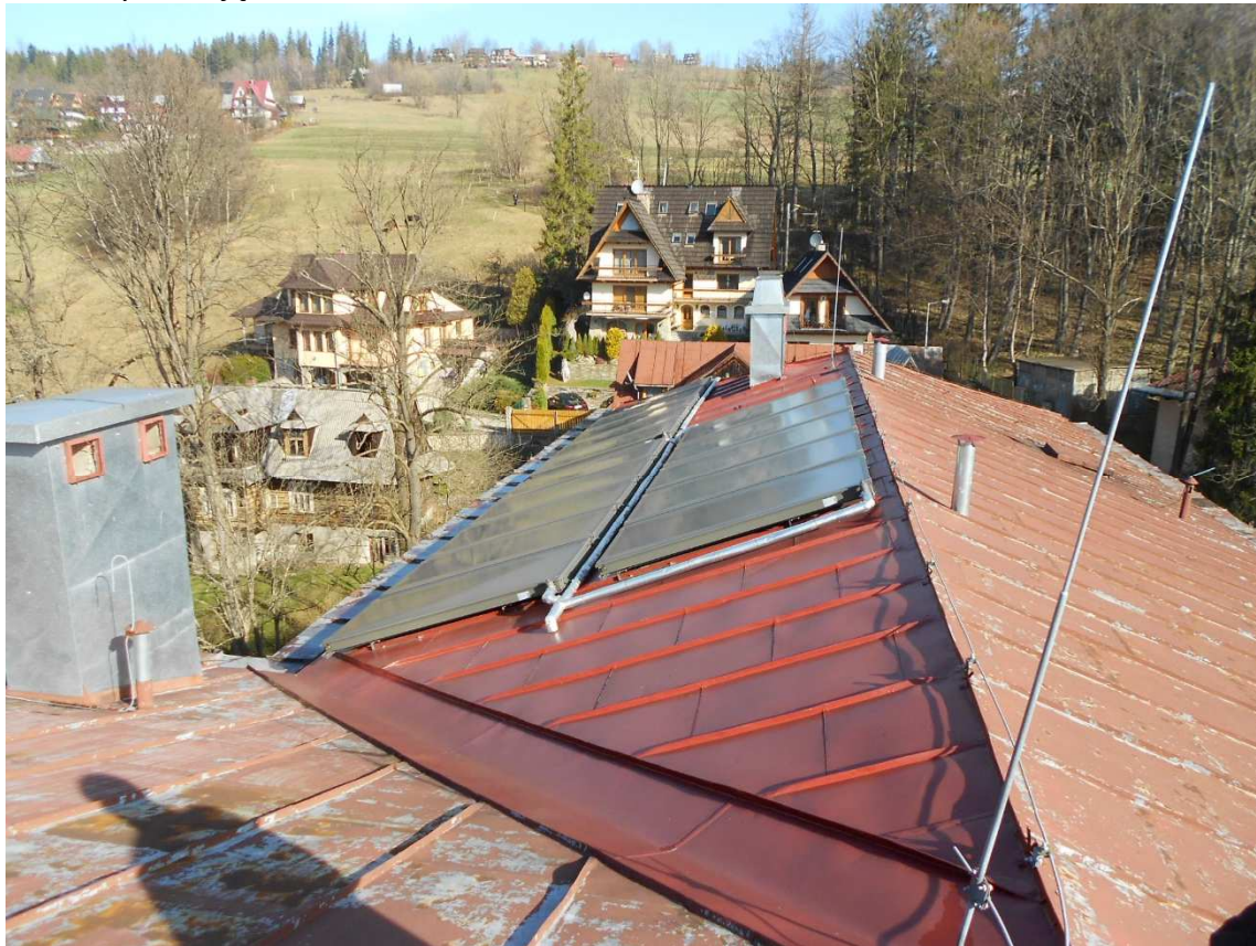
Fragment dachu z instalacją solarną.
