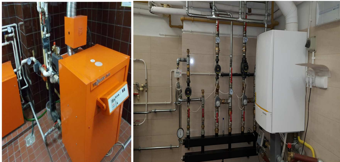
Piec dwufunkcyjny do ogrzewania oraz przygotowania c.w.u. przed i po modernizacji.
