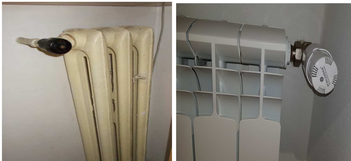
Jeden z wielu wymienionych grzejników wraz z regulacyjnym zaworem termostatycznym (przed i po modernizacji).
